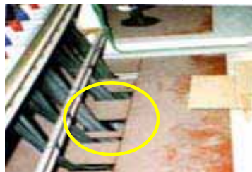
【ネズミの侵入箇所】
